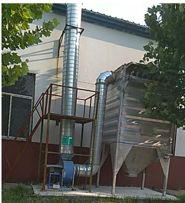
布袋除尘器+采样平台
