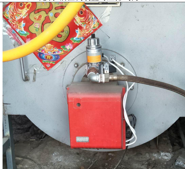
天然气锅炉安装的低氮燃烧器
