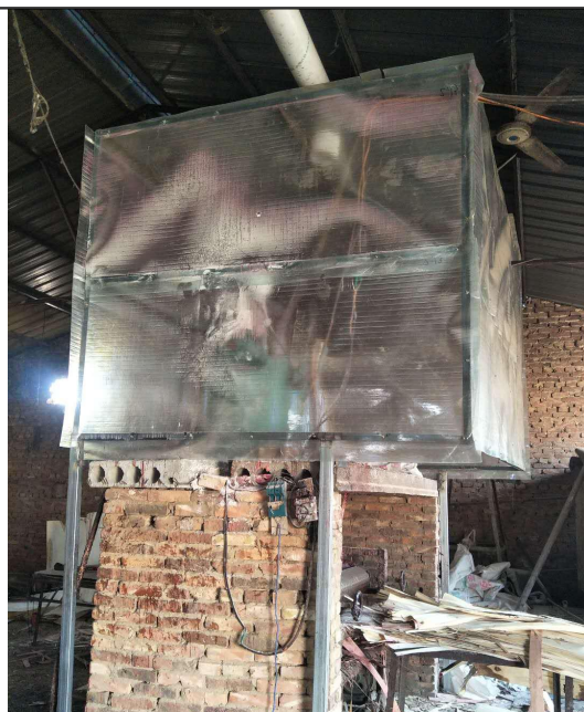
车间内集气罩安装情况
