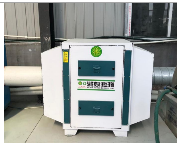
活性炭环保处理设施
