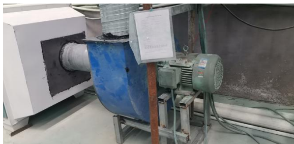
小实验室废气处理设施
