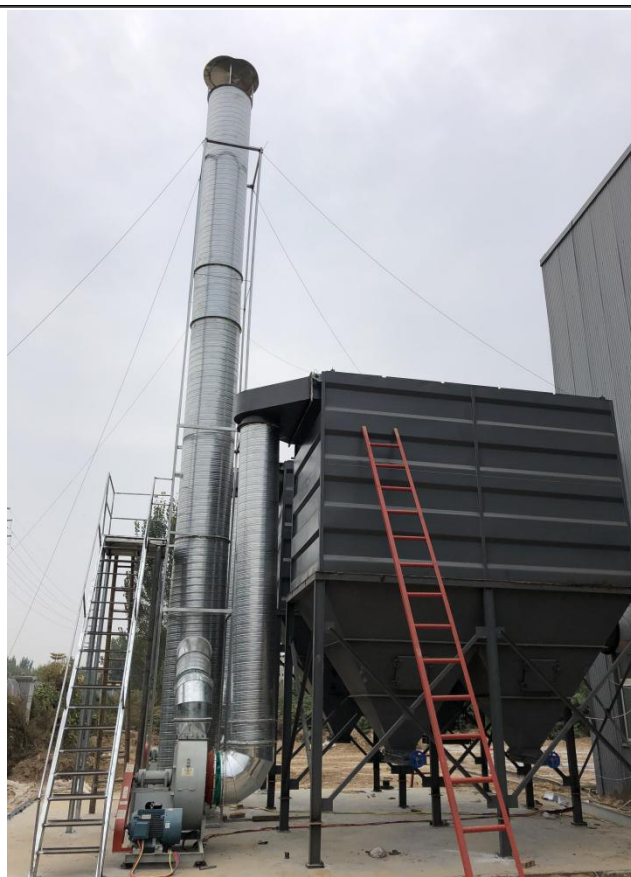
布袋除尘器+15 米排气筒
