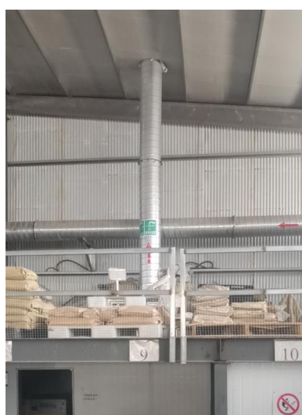
废气治理设施现场照片
